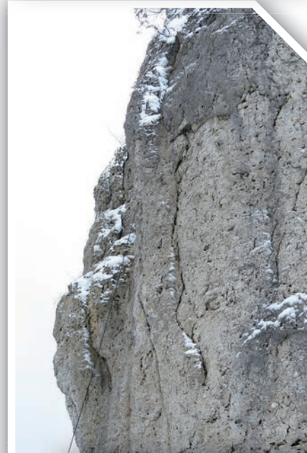
Bild 4: Schalige Verwitterung an den Flanken des Burgfelsens.
